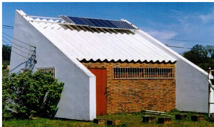
Figura 1: Sistema fotovoltaico autônomo instalado no prédio anexo ao Laboratório de Energia Solar da UFRGS.
