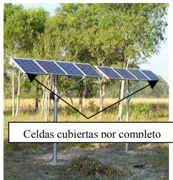
Figura 9.- Vista del banco de 400 Wp.
