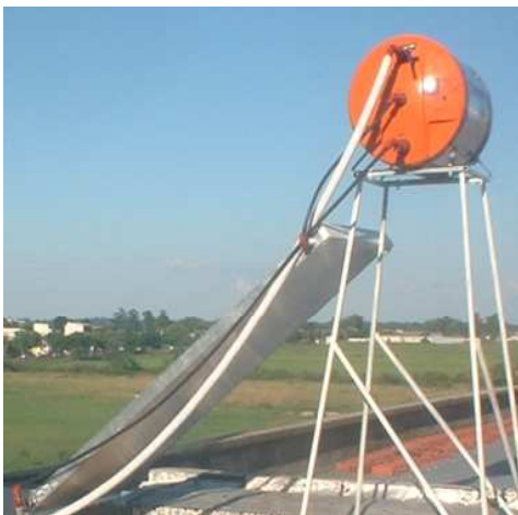
Figura 3.- Fotografía del calefón solar instalado en la terraza de la Facultad de Ciencias Exactas UNNE.
