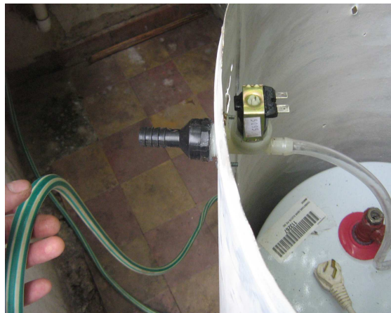
Figura 4.- Fotografía donde se aprecia la electroválvula de ingreso de agua al dispensador y el termo-tanque de 50 l. instalado en su interior.
