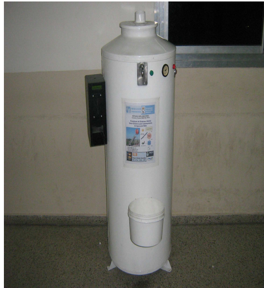
Figura 2.- Fotografía del dispensador de agua caliente instalado en el segundo piso de de la Facultad de Ciencias Exactas UNNE (área de Física).
